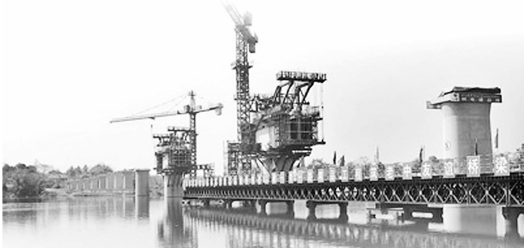
在中老铁路欣合楠里河特大桥施工现场，工程人员正在进行桥台和桥墩建设。
